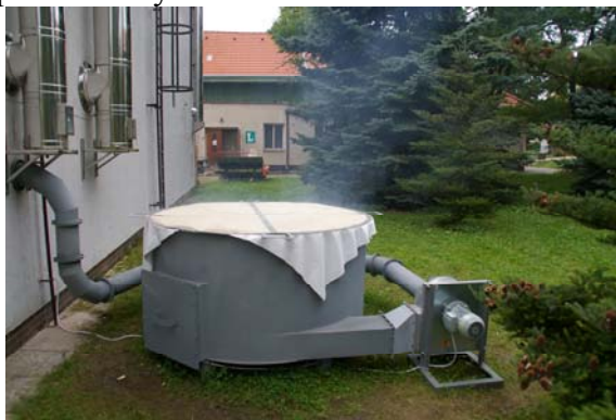
Obr. 6: Vývod kouřového potrubí k filtru
